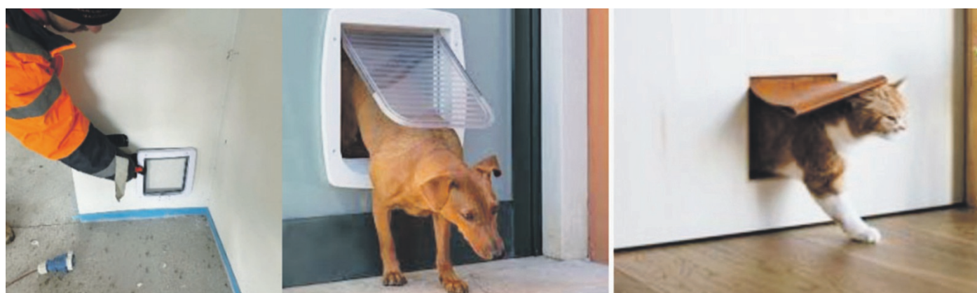
Cantiere in provincia di Mantova; i clienti hanno voluto posizionare un passaggio nella muratura per consentire ai propri gatti di girare liberamente tra la zona giorno e la zona notte. È molto importante studiare anche i passaggi di ingresso e uscita che consentano a cani e gatti di muoversi in autonomia
