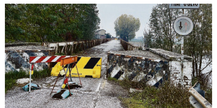
CALVATONE. Il ponte sull'Oglio che collega Calvatone con Acquanegra sul Chiese. L'8 giugno 2023 la struttura è stata chiusa per il gravissimo stato di degrado
