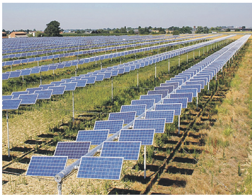
L'agrivoltaico permette di sfruttare al meglio ogni metro quadrato del terreno. I pannelli solari, installati sopra le colture o gli allevamenti, non ostacolano le attività agricole, ma le integrano
